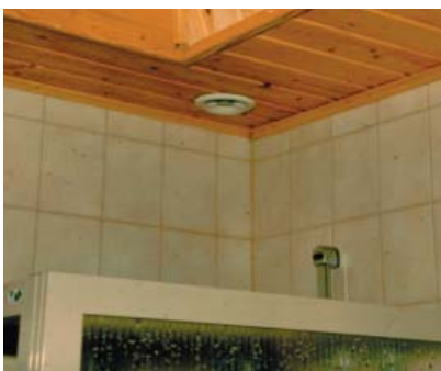
Abluftventil im Bad
