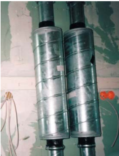
Schalldämpfer im Rohrnetz einer Zu-/Abluftanlage. Das Rohrnetz muss aus glatten Materialien mit geringem Strömungswiderstand bestehen (hier: Wickelfalzrohr).
